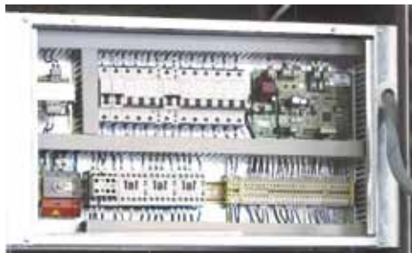
Quadro elettrico modulare Modular electrical cabinet
